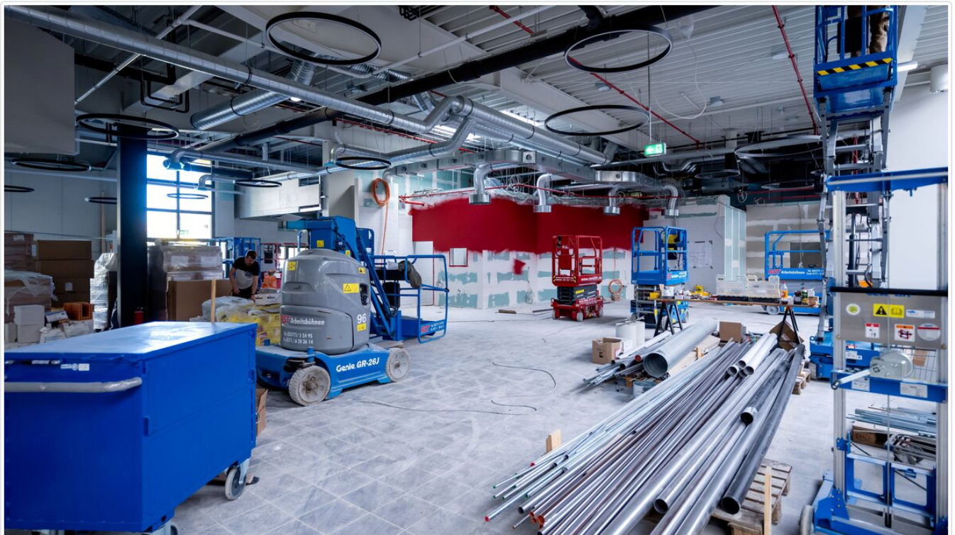
Am 1. November 2023 hat es noch so im Eingangsbereich des Marktkauf in Bautzen ausgesehen. Fünf Wochen später ist alles hergerichtet. © Steffen Unger
